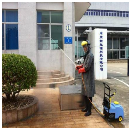
图片2 水雾灭火器 (穿着 PPE 防止触电)
